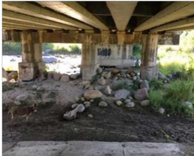
Fuente. Se observa socavación local en apoyos y acumulación de rocas, Imagen propia (2022).
