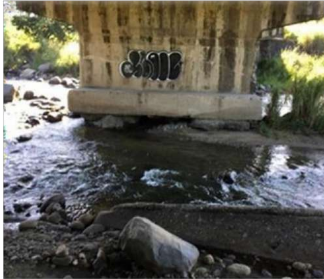
Fuente. Se observa socavación en apoyos y acumulación de rocas; Imagen propia (2022).
